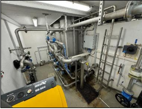
Abbildung 10: Filterkessel im EG Rohrkeller
