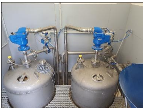
Abbildung 9: Filterkessel im EG
