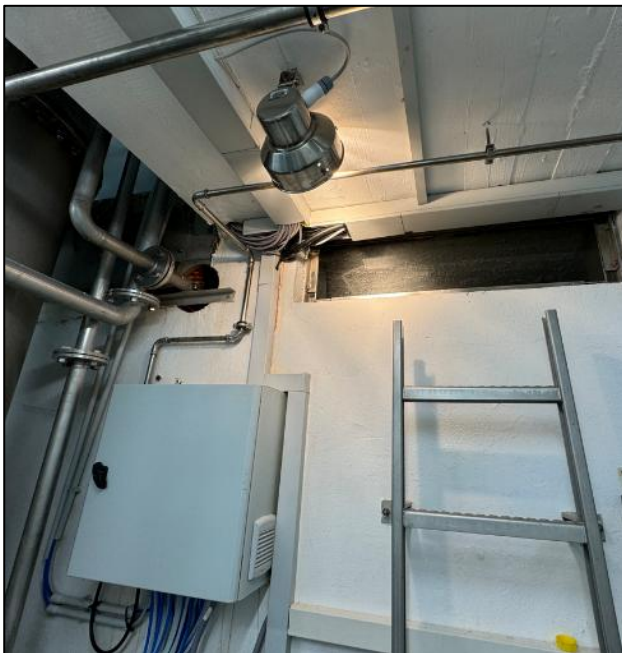
Abbildung 17: Steuerschrank Filter, Fenster Wasserkammer
