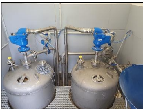
Abbildung 9: Filterkessel im EG
